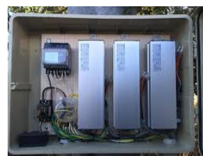
安定器BOXに収納された安定器
