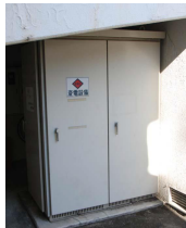
高圧受電設備(キュービクル)
