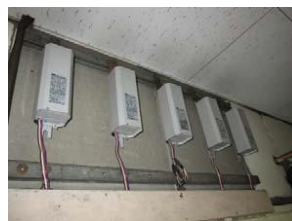
工場等の壁際に設置されている例
