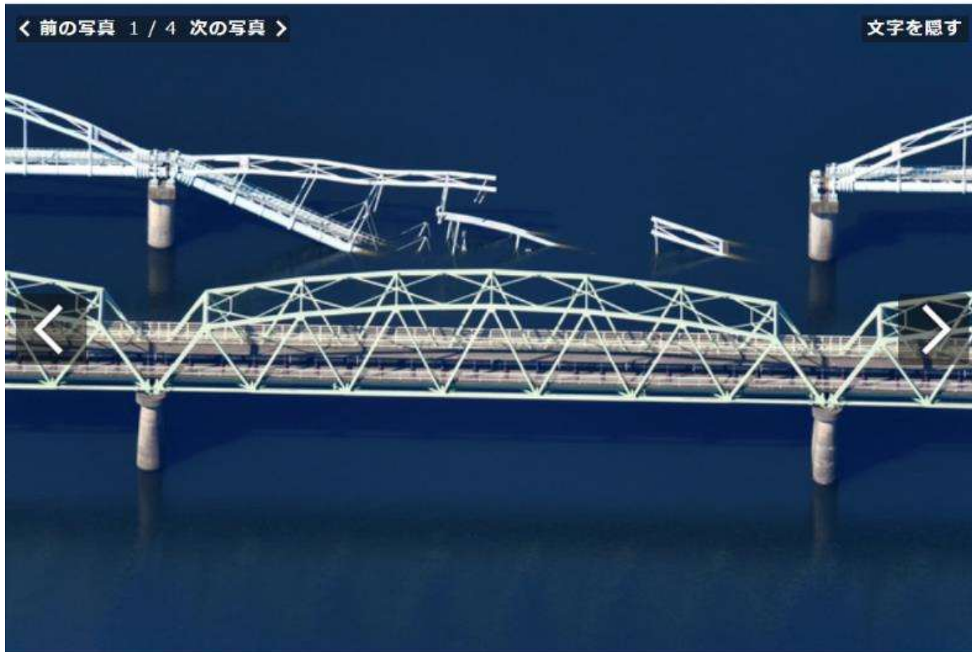
県道の六十谷橋に仮設した水管（手前）と崩落した水管橋=2021年10月9日午前9時37分、和歌山市、朝日放送
