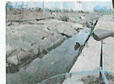
河川護岸決壊(仙台市宮城野区衛生地区)
