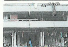
壊滅的な被害を受けた女川町役場
