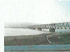
一部が崩落した新北上大橋
