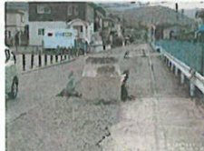
波状化によるマンホール等浮き上がり
