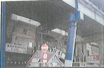
橋脚橋脚の被災
